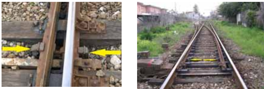
Fig. 1.5 - Blocco operativo di binario mediante morse (stazione di Ardore)
