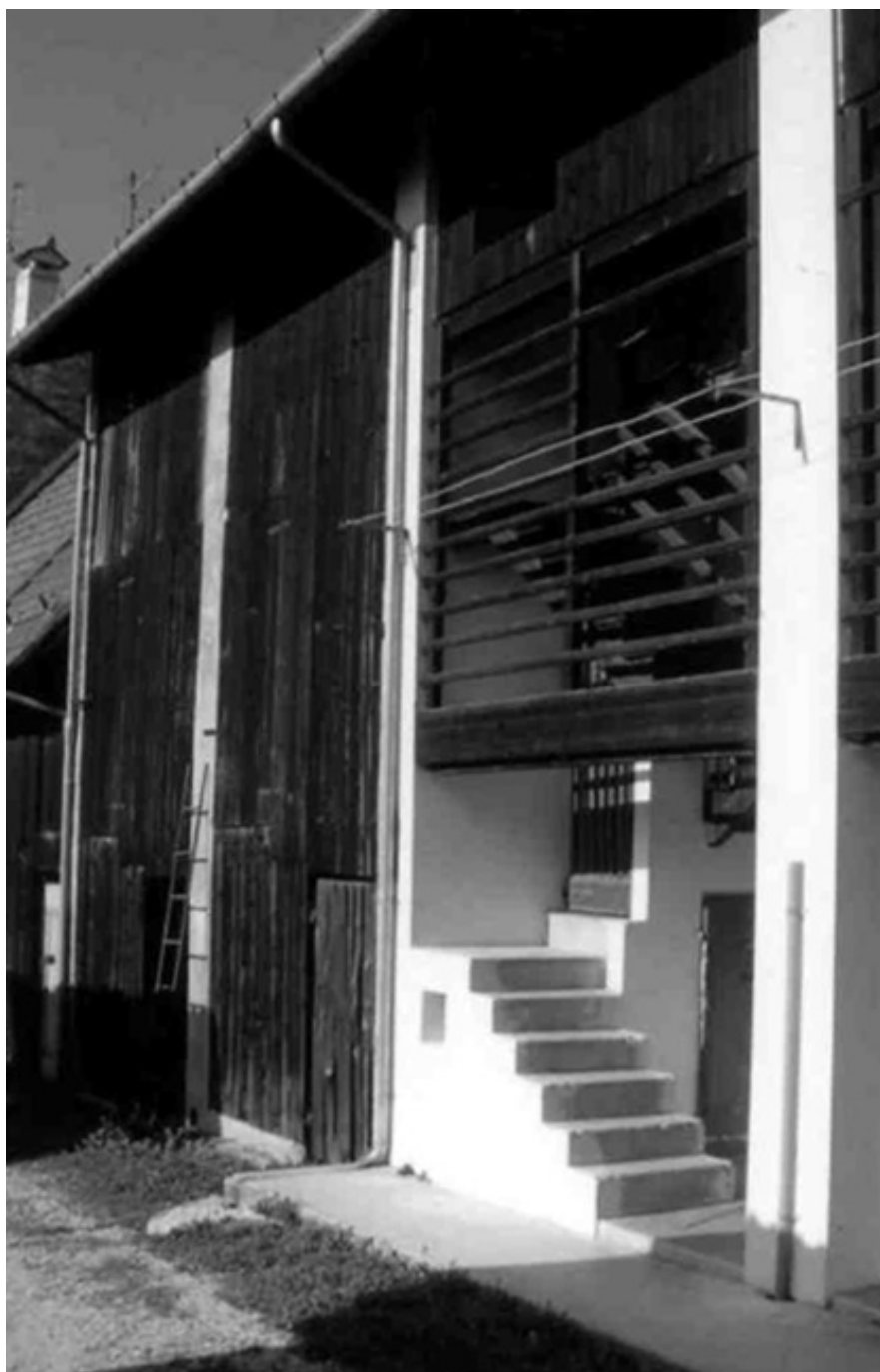
Fig. 1 - Casa del tipo "a ballatoio su setti" nel Comune di Andreis (PN), esempio tipico di inserimento all'interno di una schiera. A sinistra il rustico e a destra l'abitazione con la scala di accesso
