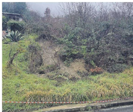
La frana in via Valfrancesca, a Sora
